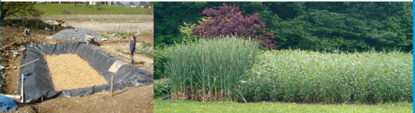
Installation eines bepflanzten Filters (links) und seine Erscheinung im Betrieb (rechts)
